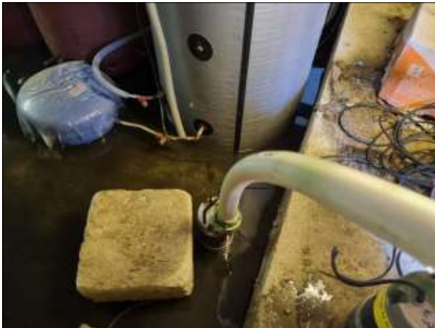
Kosaweg 29 Wasser im Keller
