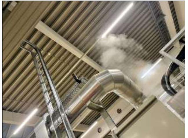
Rotfarbweg 5 - Rondo Ganahl AG BMA durch Dampfaustritt ausgelöst
