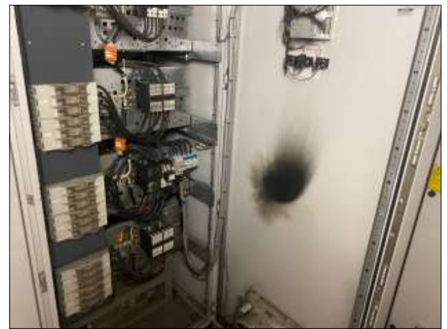
Rotfarbweg 5 - Rondo Ganahl AG BMA durch durchgebrannten Schutz ausgelöst
