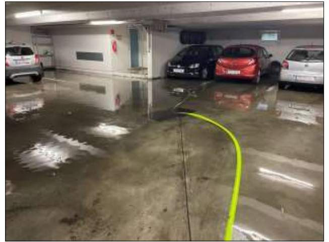
Starkregen Wasser in der Tiefgarage
