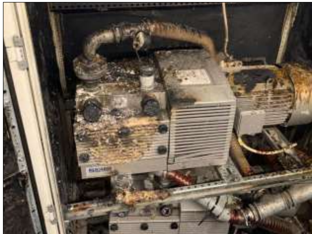
Rotfarbweg 5 - Rondo Ganahl AG BMA durch einen Motorbrand ausgelöst
